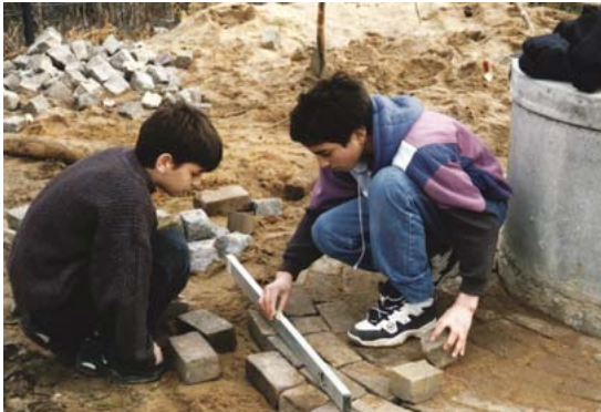
Beim Pflastern im Schulgelände ist präzises Arbeiten mit der Wasserwaage gefragt. Foto: K. Kurtz
